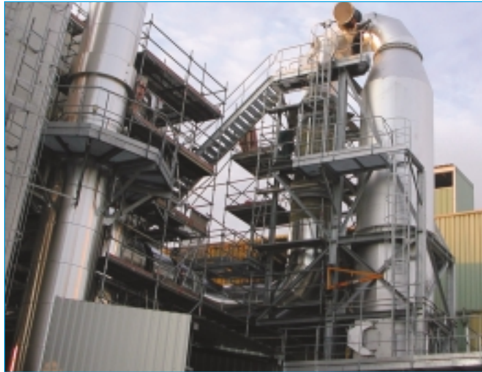
In deze vuilverbrandingsinstallatie zorgt AutoJet ervoor dat de temperatuur van de verbrandingsgassen gekoeld worden.
